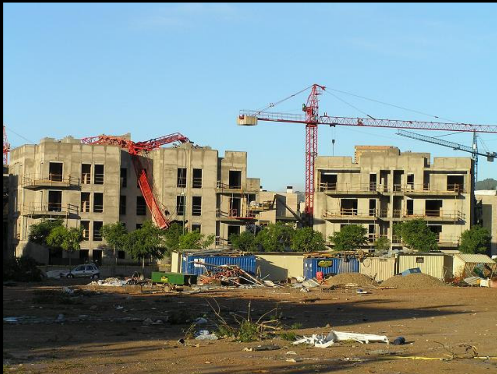
Figura 30. En esta foto se observa un solar lleno de escombros, entre ellos un contenedor de papel de reciclaje. Hay varias estructuras metálicas escampadas por el solar. Además una grúa, literalmente destrozada, se "abrazo" sobre el edificio en el cual estaba.
