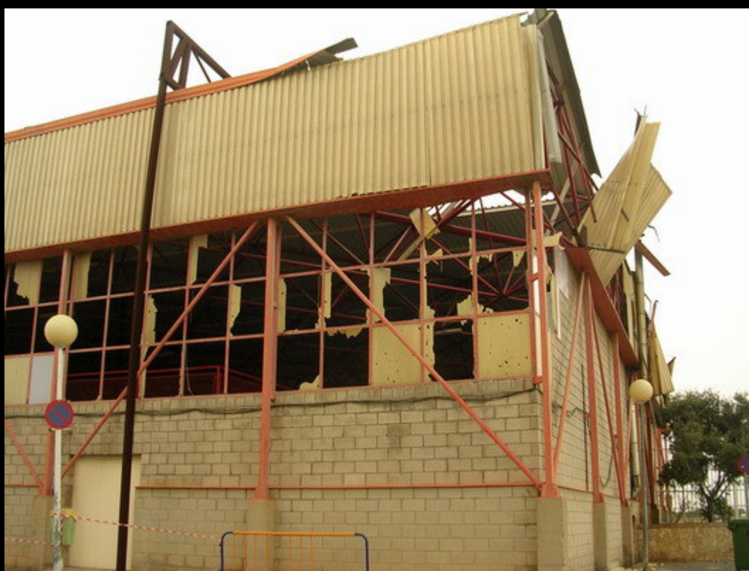
Foto 28 – El polideportivo de Sagunto perdió el techo y quedó prácticamente destruido.
