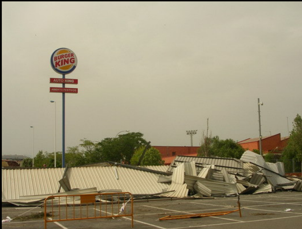
Foto 25 – Los tejados del aparcamiento del Carrefour de Sagunto volaron y se desplomaron.
