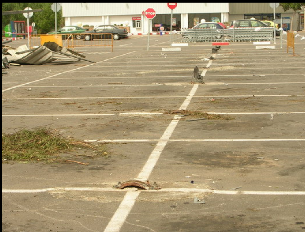
Foto 27 – Antes aquí había un techado para aparcamientos. Fijaos el grosor de los anclajes.
