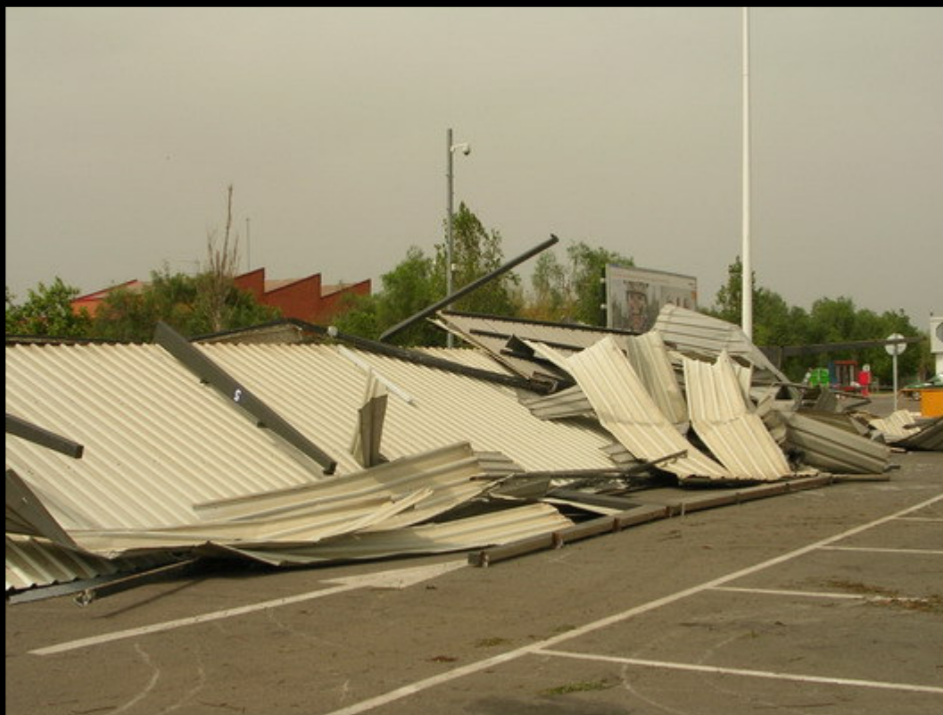
Foto 26 – Por la hora a la que se produjo el tornado, no se produjeron víctimas ni daños en coches.
