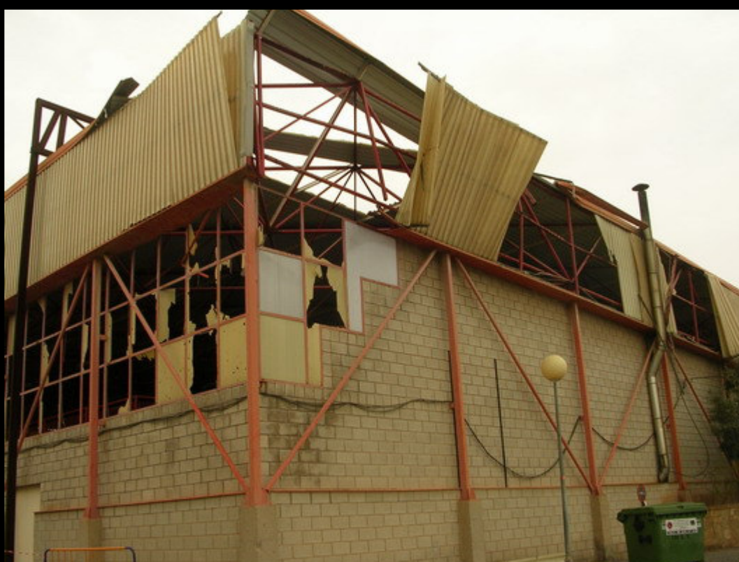
Foto 29 – Acribillado por el granizo y desprovisto de las planchas de protección, será difícil reconstruirlo.
