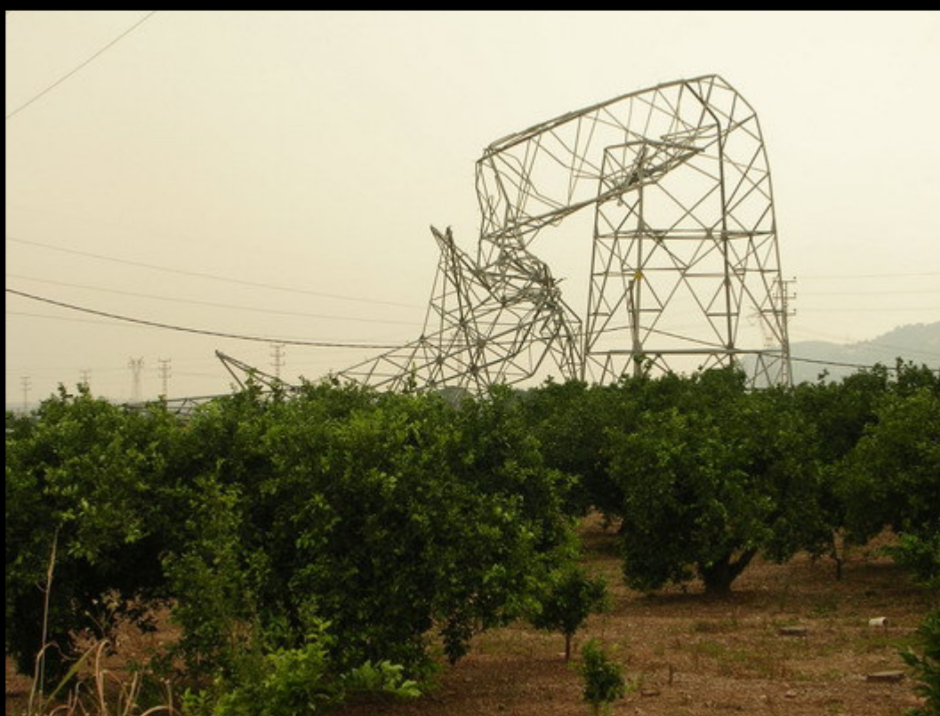
Foto 36 – Una torre no sólo caída, sino retorcida de forma increíble.
