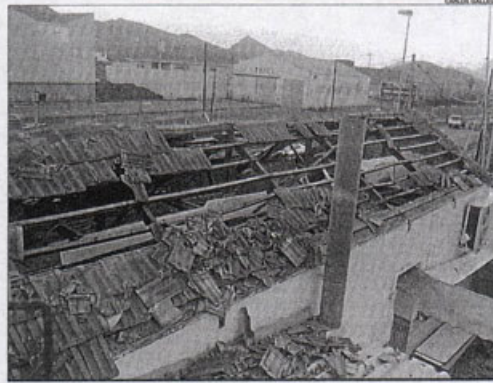
Aspecto que presentaba uno de los tejados afectados por el tornado
