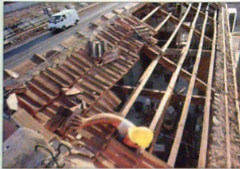
Trabajos a marchas forzadas. Vista Alegre volvió ayer a la calma tras el sobrevuelo del barrio. Sin embargo, en sus calles todavía quedaban restos de escombros esparcidos por el torbellino y en varias viviendas los albañiles se afanaban en la retirada de escombros y vigas rotas. En uno de los lugares donde se trabajó a marchas forzadas fue en el antiguo bar El Anfibio, en la carretera de La Unión, cuyo tejado voló por la fuerza del viento. En la imagen, un trabajador retira las tejas de la cubierta.
