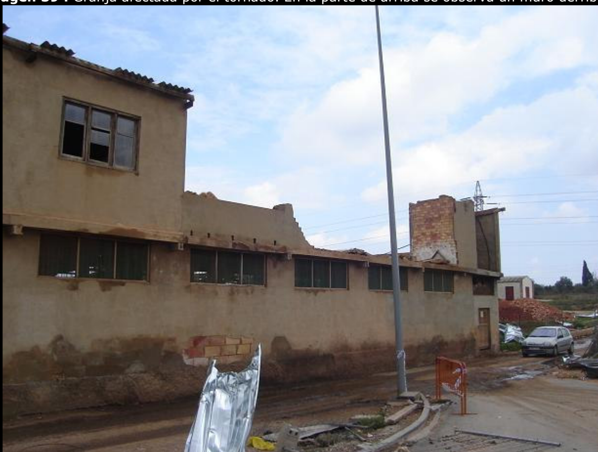
Imagen 39 . Granja afectada por el tornado. En la parte de arriba se observa un muro derribado.
