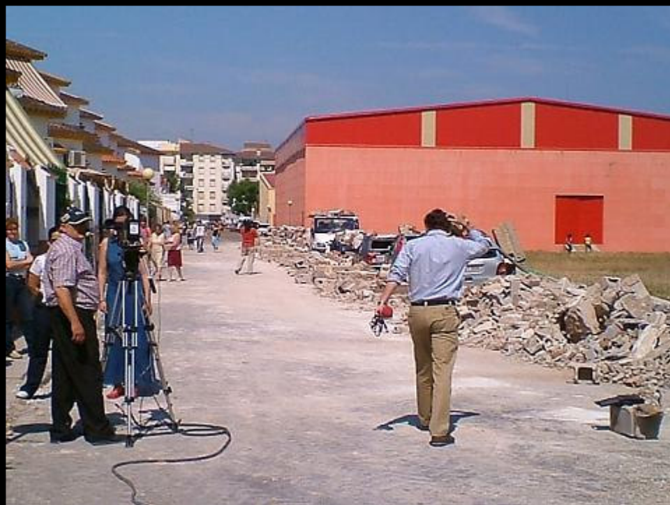
Árboles tronchados, muros rotos por caída de ramas...
