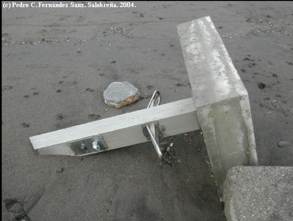
Fig. 4. Ejemplo de los daños (II). Fuente: material fotográfico propio.
