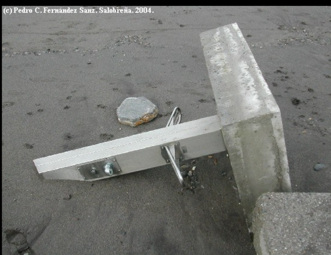
Fig. 16. Lavapiés como éste, anclados a enormes losetas de hormigón armado de varias toneladas, fueron desplazadas como si se tratase de cualquier piedrecilla.
