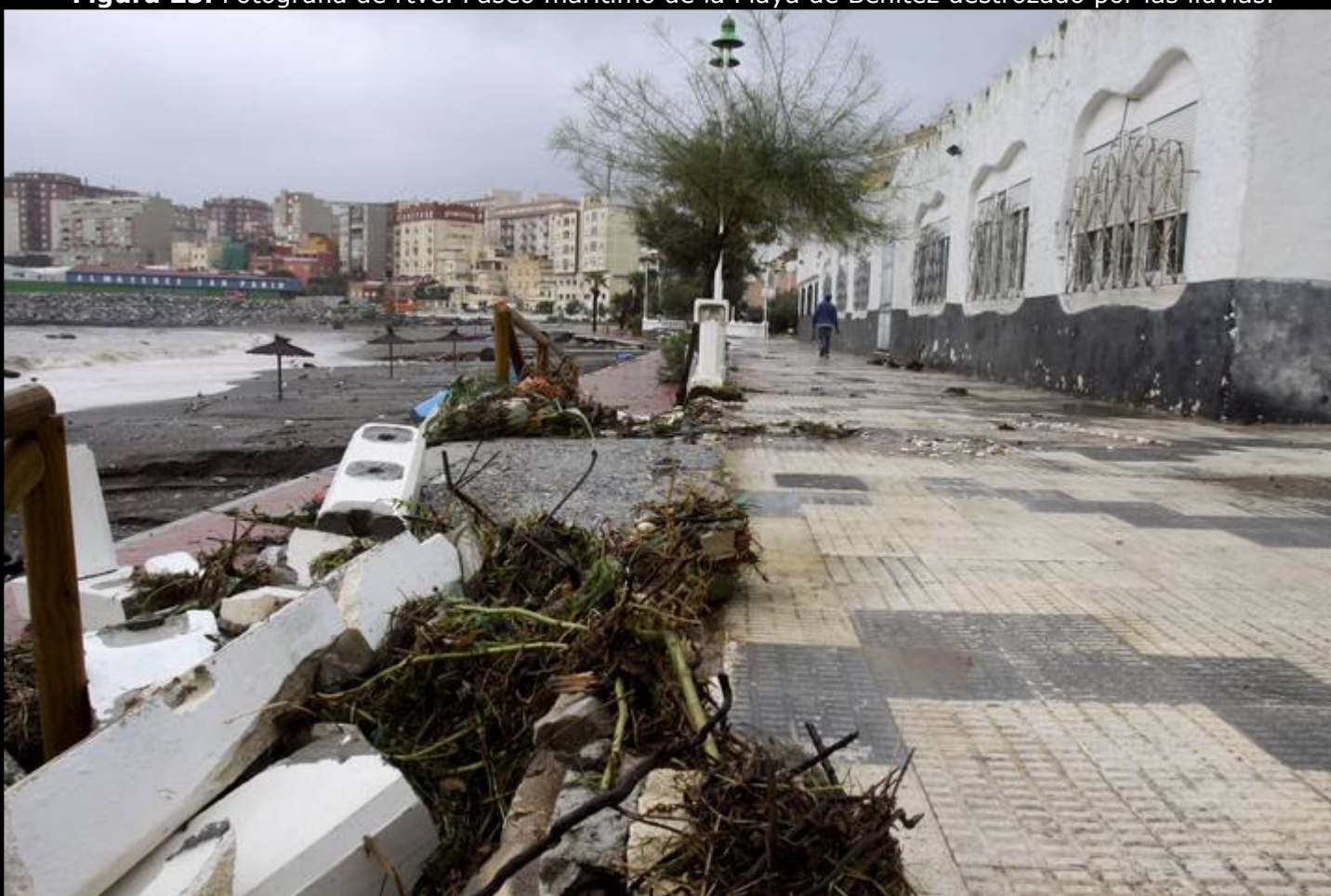
Figura 25. Fotografía de rtve. Paseo marítimo de la Playa de Benítez destrozado por las lluvias.
