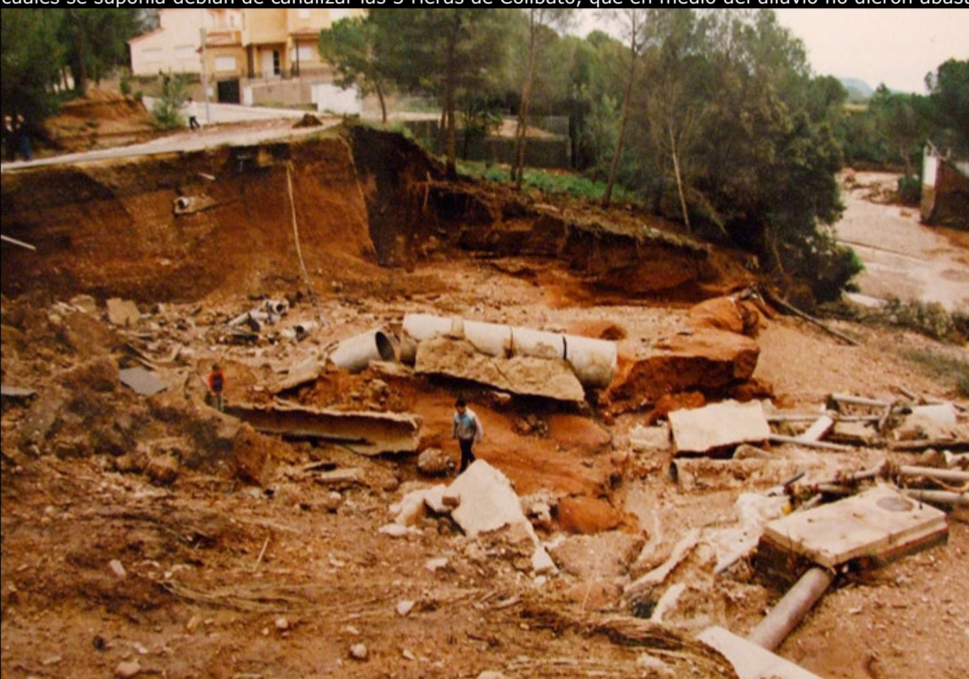
Imagen 25: En medio de toda la runa y el barro (antes carretera) podemos ver unos pequeños conductos (de unos 80 cm de diámetro) los cuales se suponía debían de canalizar las 3 rieras de Collbató, que en medio del diluvio no dieron abasto.
