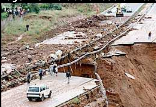
Imagen 26: Trozo de la Nacional II caído.
