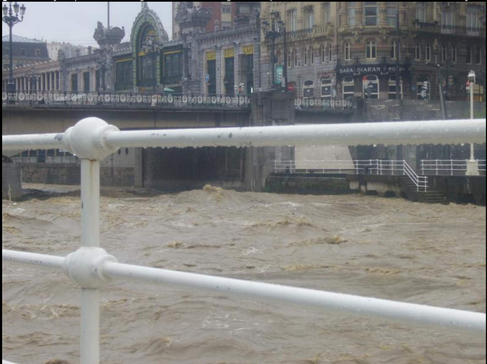
Figura 27: Foto para ilustrar la fuerza con la que el agua empujaba a los pilares del Puente del Arriaga.
